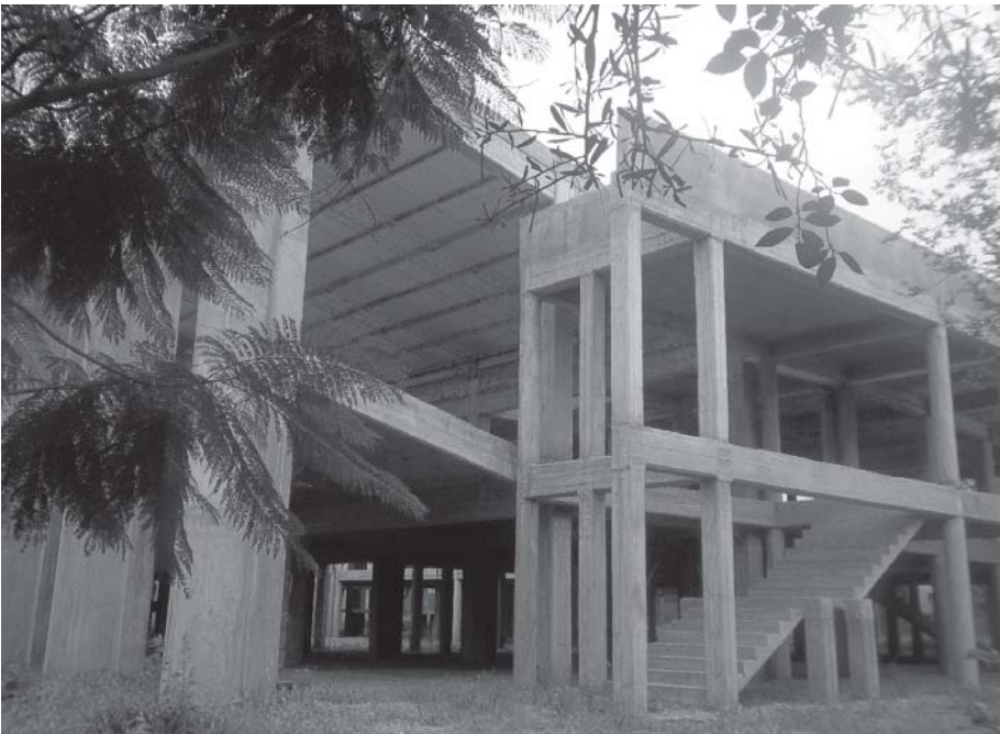
Aulas en construcción en el campus de la Universidad Nacional de Salta. Foto: Viviana Cristina Ceballos
