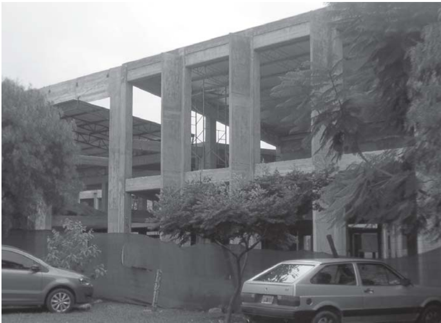
Aulas en construcción en el campus de la Universidad Nacional de Salta Foto: Viviana Cristina Ceballos
